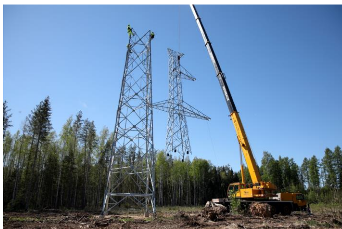
10. att. Trešais elektriskais starpsavienojums starp Latviju un Igauniju pirmā balsta pacelšana, 2019. gada 16. maijā
